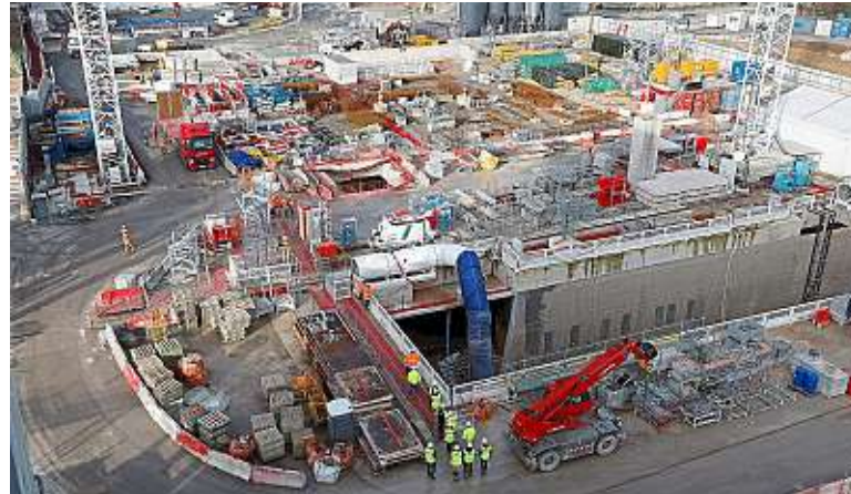
Le drame a eu lieu sur le chantier de la station de métro Saint-Denis-Pleyel (ici le 2 février). L. Marin / AFP
